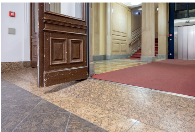
Gefälle beim Zugang zu Lift und Treppe
