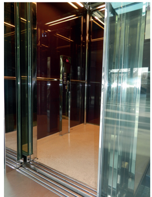
Lift Stadthalle und Messe Süd
